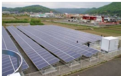
矢掛 太陽光発電所
